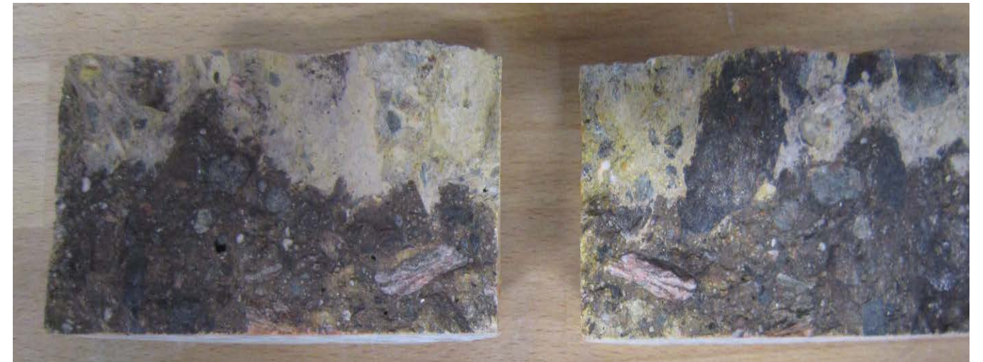
Chlorideindringtiefe eines gespaltenen Bohrkerns
