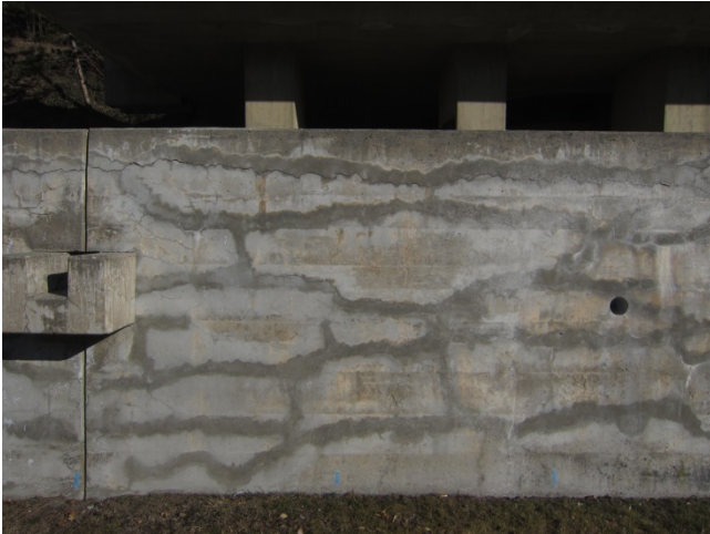
Abb. 4-2 Teilansicht Stützmauer mit durchgeführter Rissinstandsetzung
