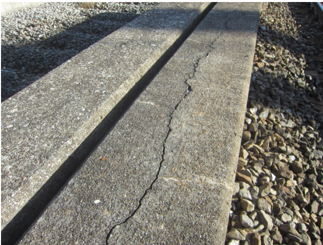
Abb. 2-4 klaffender Längsriss an der Oberseite der Brückenbrüstung
