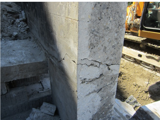
Abb. 4-5 Ansicht Schnittfläche Wandelement horizontaler Trennriss
