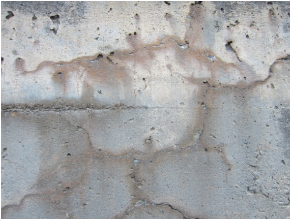
Abb. 2-1 typisches AKR-bedingtes Rissbild mit dunklen Riss säumen
