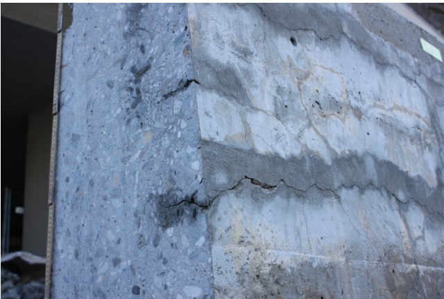
Abb. 4-4 Ansicht Schnittfläche Wandelement Gut zu erkennen ist der Verlauf der Risse von der Oberfläche in die Wand hinein.
