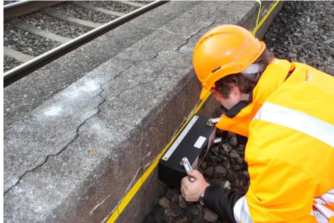
Abb. 14 Ultraschall-Messung bei einer AKR-geschädigten Brüstung bei einer Eisenbahnbrücke [7]
