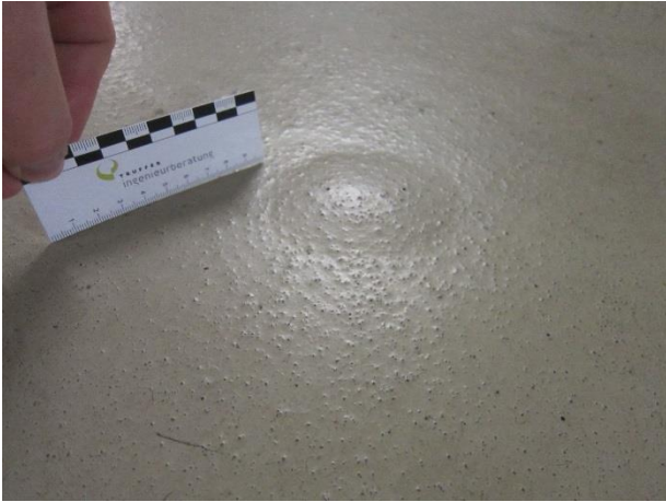
Abb. 5-9 Blasenbildung in einer Parkdeckbeschichtung
