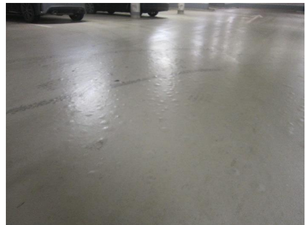
Abb. 5-8 Blasenbildung in einer Parkdeckbeschichtung
