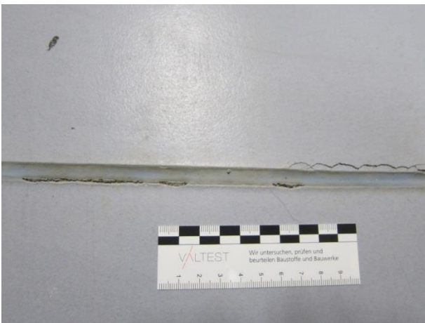
Abb. 3-2 fugenparallele Risse beidseitig der elastischen Fuge
