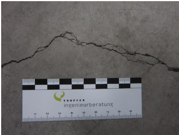
Abb. 2-2 typischer langgezogener Riss in der Bodenplatte
