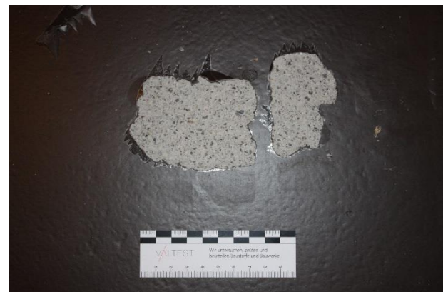
Abb. 4-2 lokale Ablösung der gesamten Beschichtung vom Zementestrich
