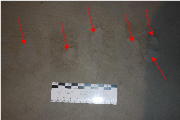
Abb. 4-3 lokale Ablösung der Versiegelung vom Untergrund
