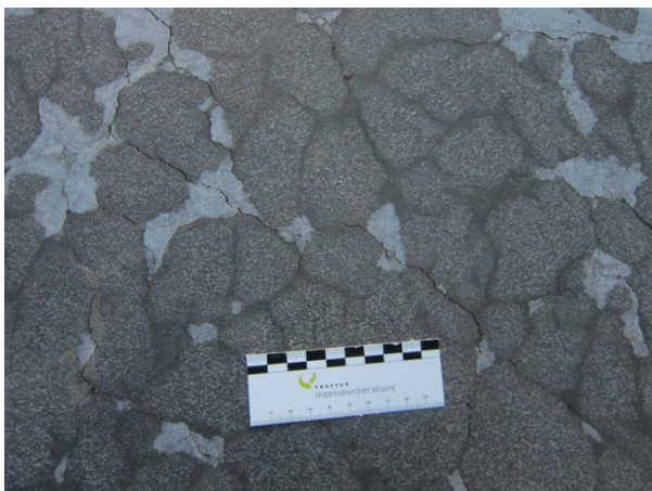
Abb. 2-6 Betonoberfläche nach zu spätem Glätten
