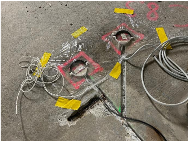
Abb. 17: Messstelle mit eingebauten Multisensoren des Korrosionsmonitorings
