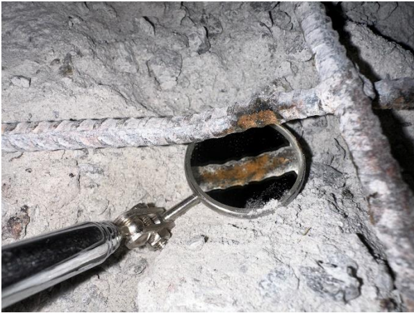
Abb. 10: Sondagestelle mit Lochfrass an der eingebauten Bewehrung
