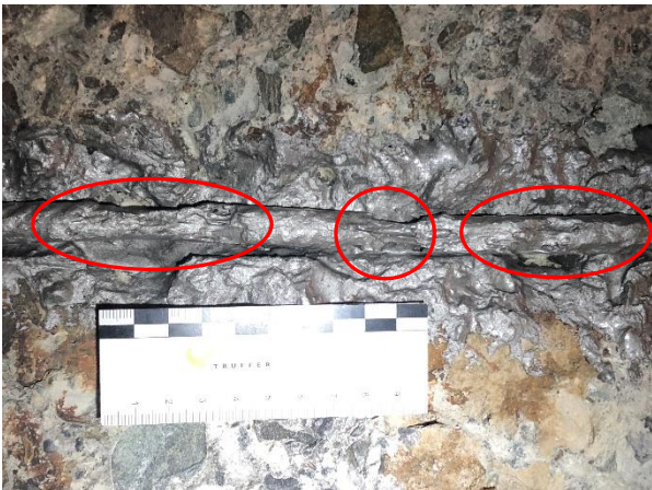
Abb. 3: Sondageöffnung Bodenplatte mit freigelegter Bewehrung. Die Bewehrung war zum Zeitpunkt der Begehung bereits mit einem Korrosionsanstrich beschichtet. Die Korrosionsstellen sind auf der Abbildung mit einem Kreis markiert.
