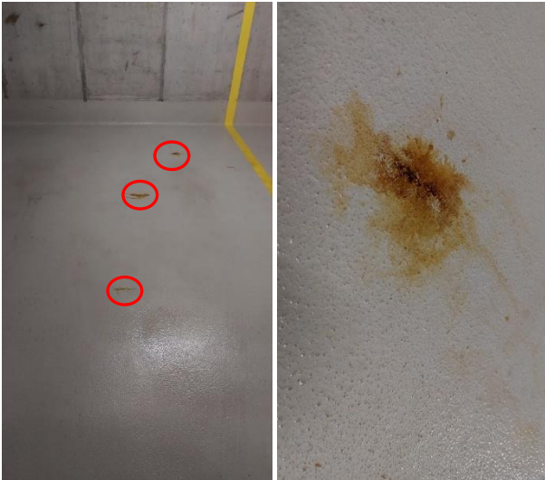
Abb. 2: Schadensbild 2022: punktuelle rostbraune Verfärbungen auf der Parkdeckbeschichtung
